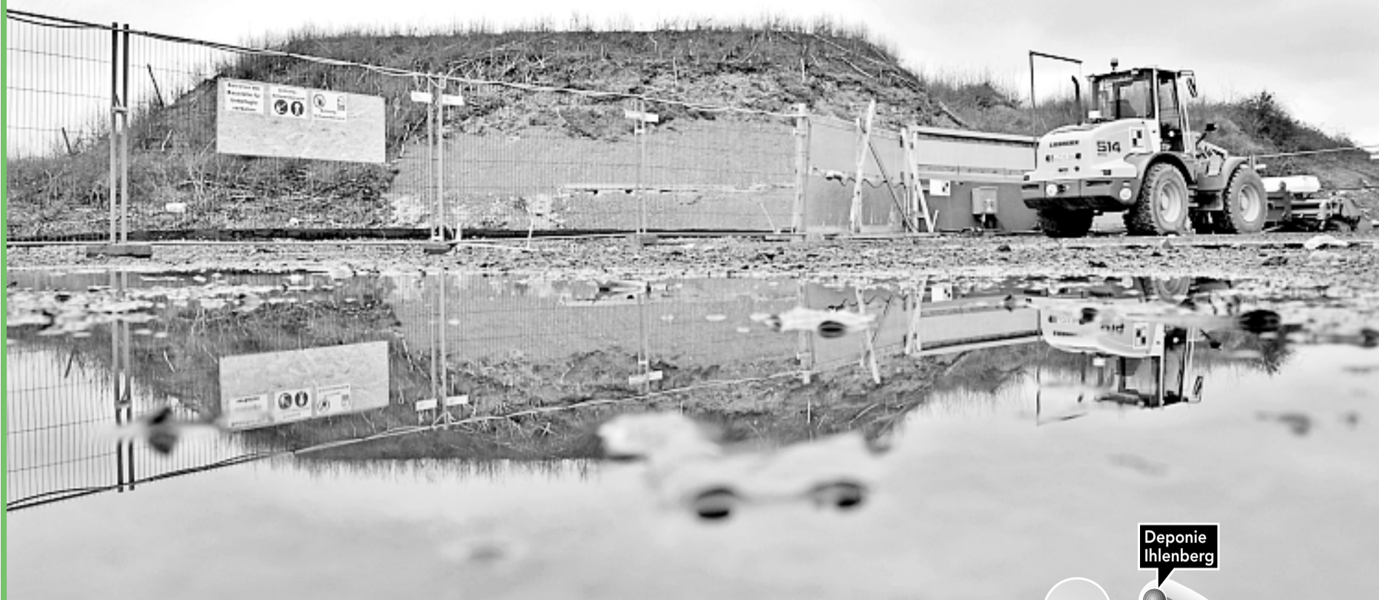
GIFTMÜLLHALDE: Meterhoch türmt sich der asbesthaltige Abfall auf der Deponie Wunstorff-Luthe. Eine Gitter-Umzäunung sperrt das Areal ab. Foto: Dröse
